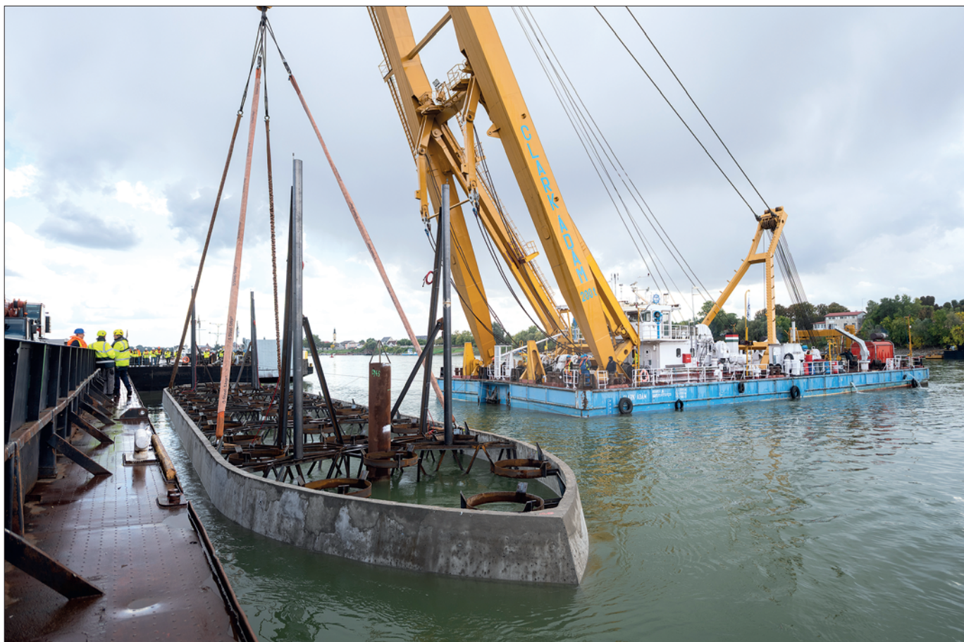
13. ábra: Mohácsi Duna-híd 'A' kéregelem beemelése a Clark Ádám úszódaruval (Fotó: Erdei Mihály, magyarepitok.hu)
