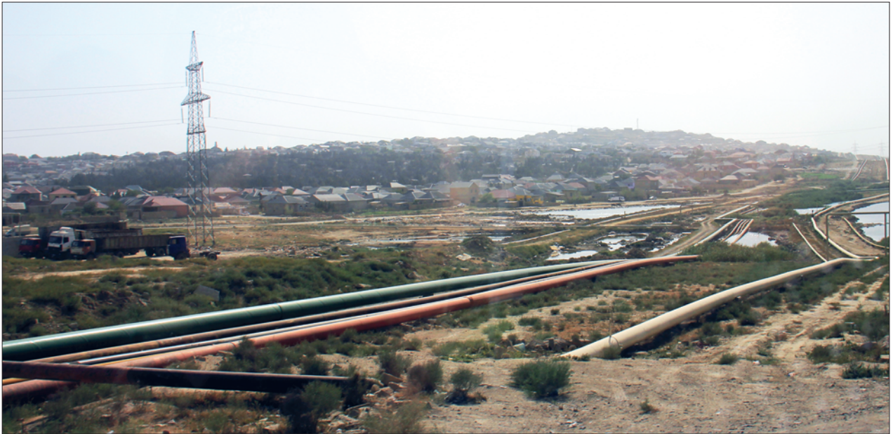
20. kép: Olajvezetékek a főút mentén
