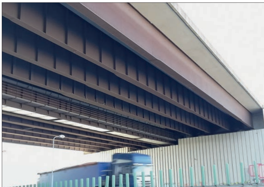
1. kép: Időjárásálló acélból készült hossztartók. Alagútszerű kialakítás (széles felszerkezet, magas hídfők) – D1 autópálya feletti híd
