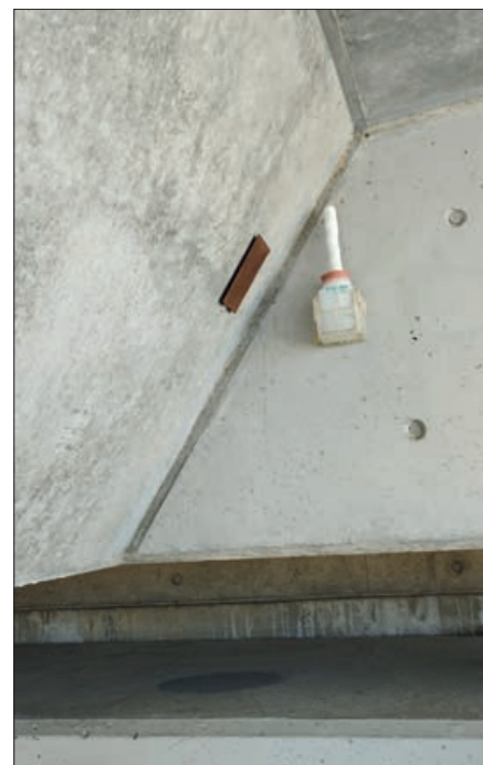
21. kép: Híd oldalfelületére helyezett időjárásálló acél mérőtest és „wet candle” mérőpont
