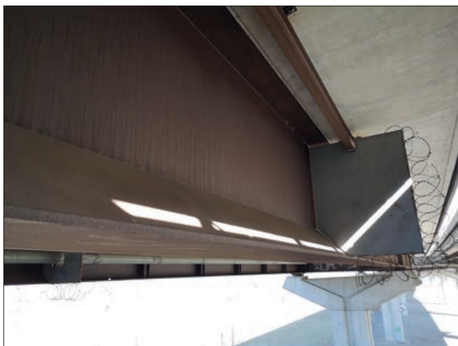
12. kép: Vízterelő lemez a hídfők környezetében
