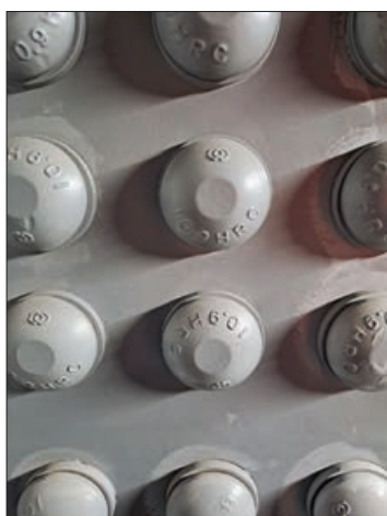
21. ábra: Pilonszárak nagy szilárdságú feszítőcsavarjai, amelyeken nincs csavarkulcsos megfogási lehetőség
